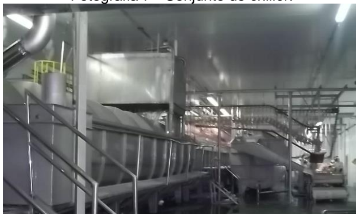
Fotografia 7 - Conjunto de chiller .
